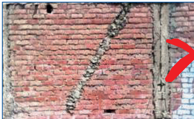
Figura 26. No picar muro portante. ¡Se debilita!
